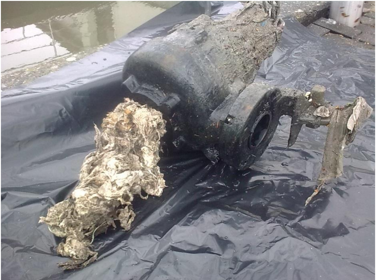
Pumpe aus dem RÜB Ziegelhütte mit Papierzopf – Dauer der Instandhaltungsmaßnahmen: 1 Tag
